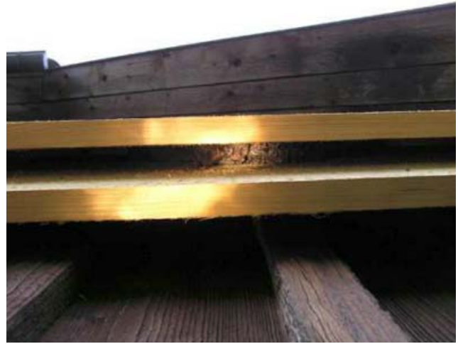
Dieses Fledermausbrett wurde auf senkrechte Leisten montiert, um trotz darunter liegendem Mauervorsprung vom Boden aus einsehbar zu sein.
